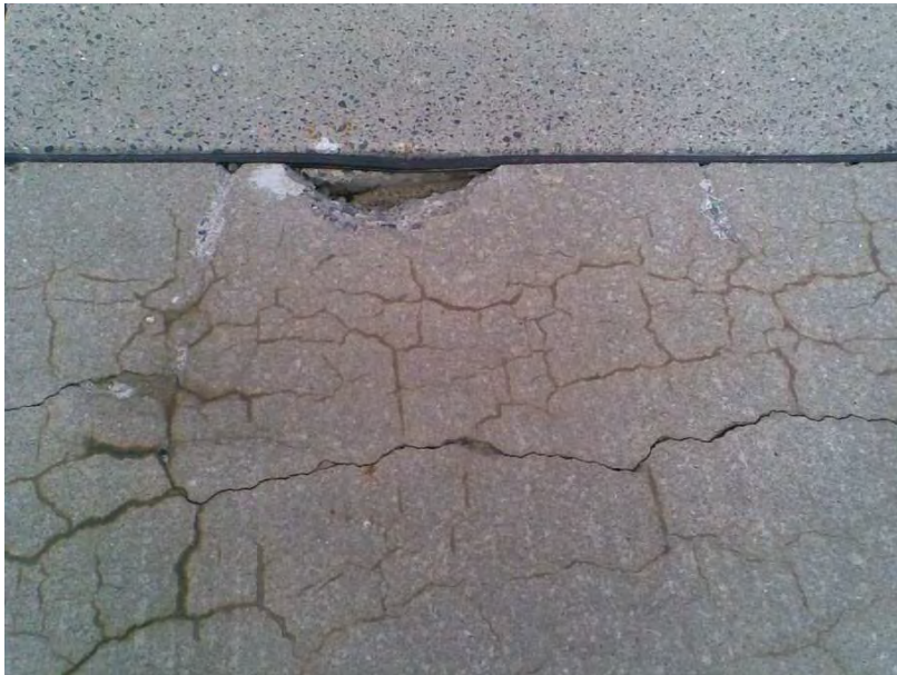
Zerstörte Oberfläche auf Vorfeld 6
